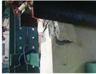
(d) Crushing and crack at the top of wall panel
